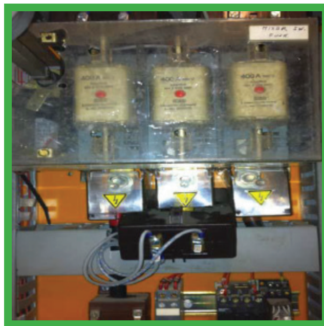
Tous les points de contact sous tension sont gainés et couverts.
