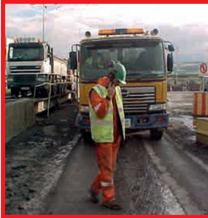
Accident mortel au sein du groupe – étude de cas 2012: un contremaître a été écrasé par un camion à béton en marche avant. Il a été distrait alors qu'il répondait à un appel sur son téléphone portable.
