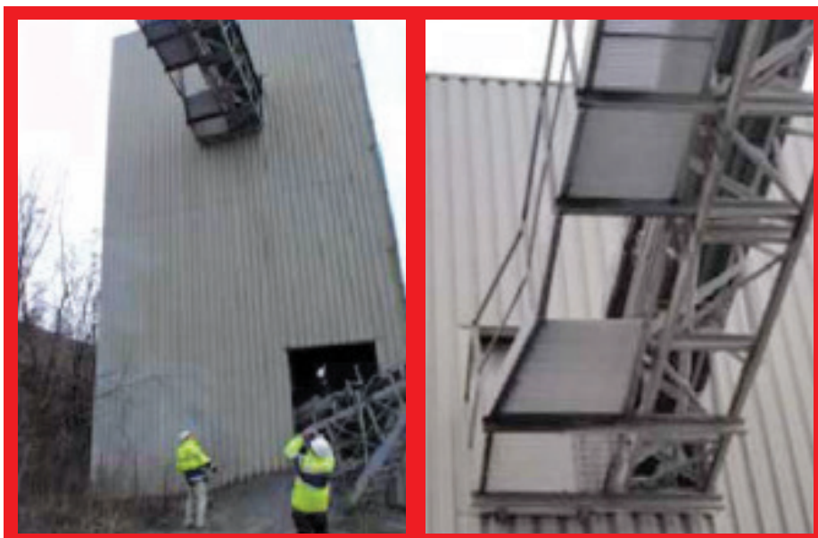
Accident mortel (site non CRH) : un travailleur a fait une chute de 14 mètres lorsqu'une partie de la grille d'une passerelle a cédé. Les boulons de fixation de la grille s'étaient desserrés au fil du temps à cause du tamis vibrant situé à proximité.
