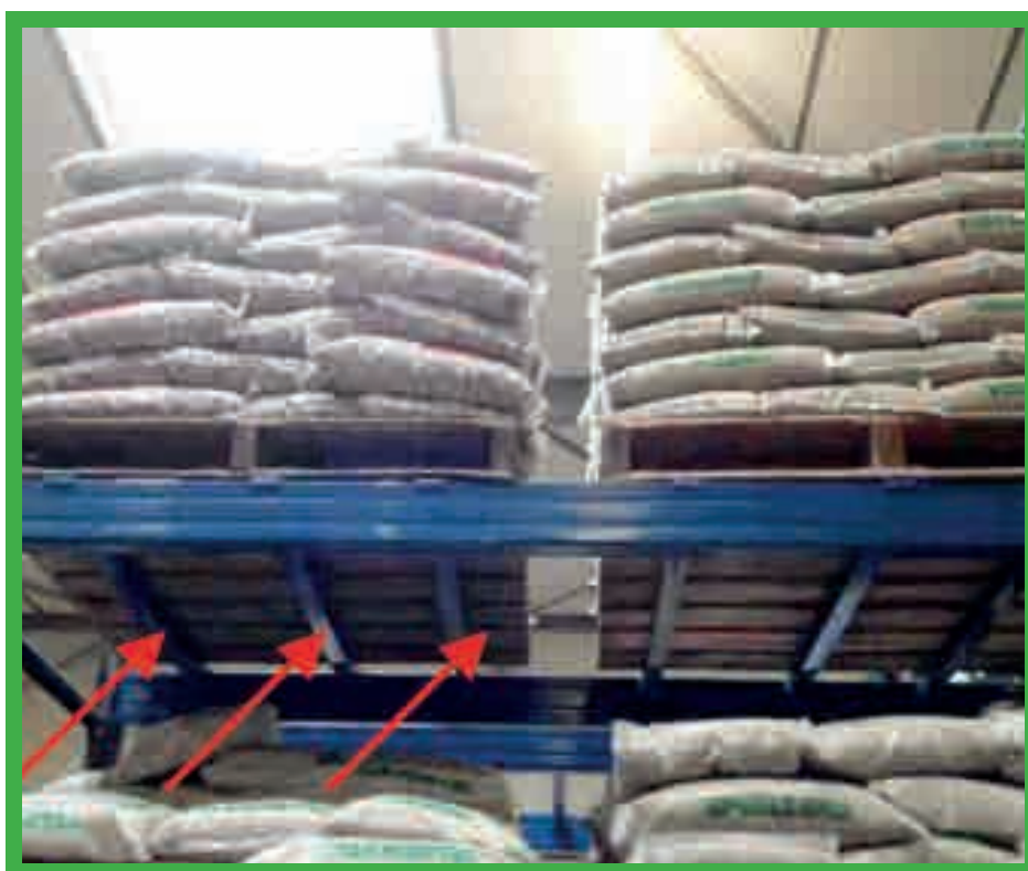
3 poutres de soutien pour les palettes de stockage.
