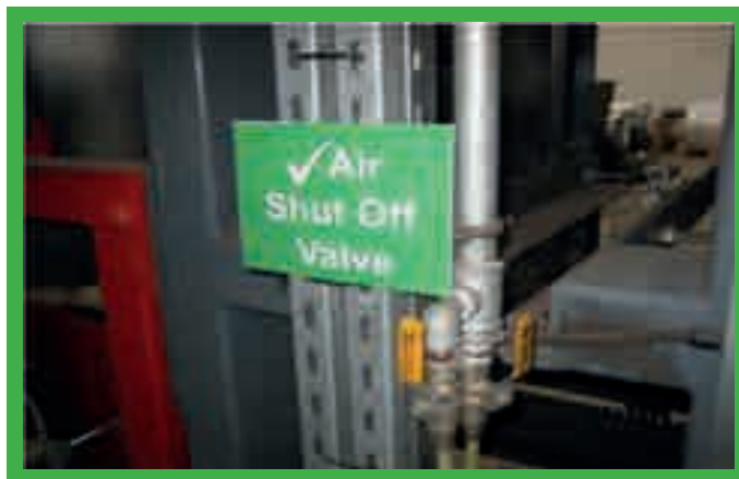
Point d'isolement pneumatique clairement identifié.
