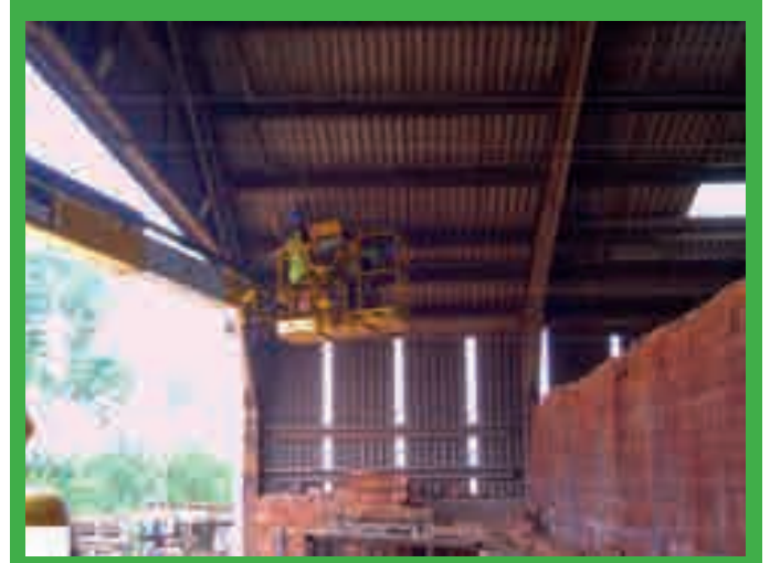
PEMP en service dans une briqueterie et une cimenterie.
