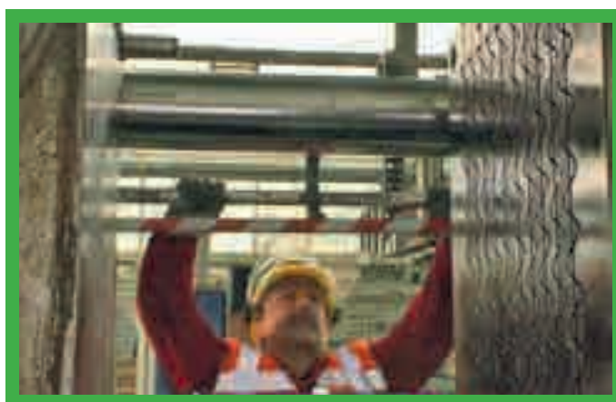
Isolement mécanique : protection d'une porte coulissante (Mécanique + Cadenas)
